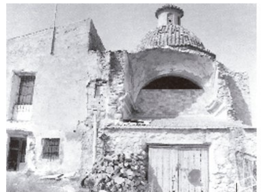
Convent de la Mercé, pràcticament enrunat.
